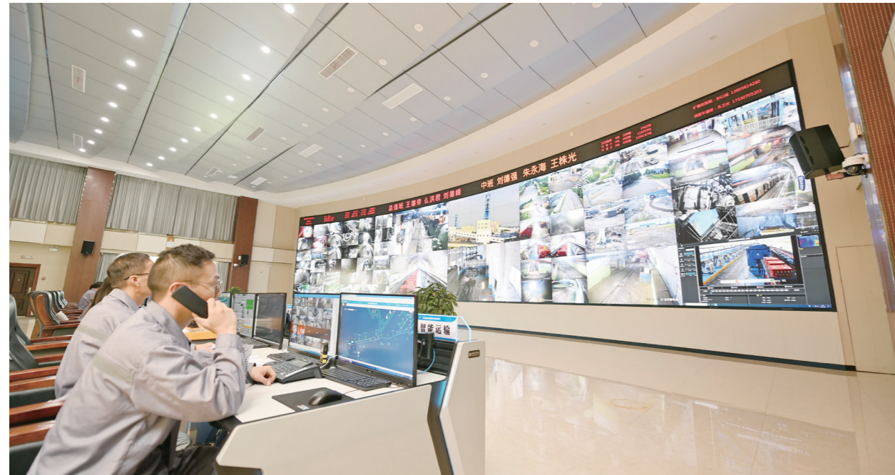
煤矿智能化调度平台
